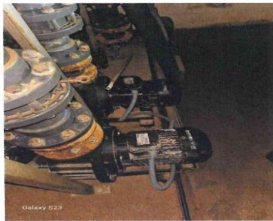
Imagen 2 - Bombas y depuradoras averiadas
