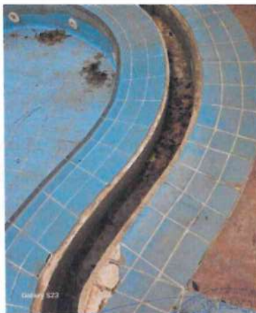
Imagen 1 - Piscina sin rejillas y pavimento cerámico roto
