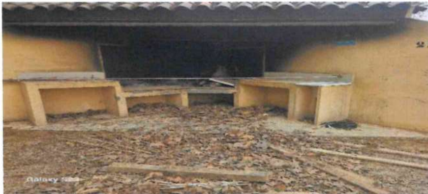
Imagen 4 - Paellers destruidos y en estado inservible
