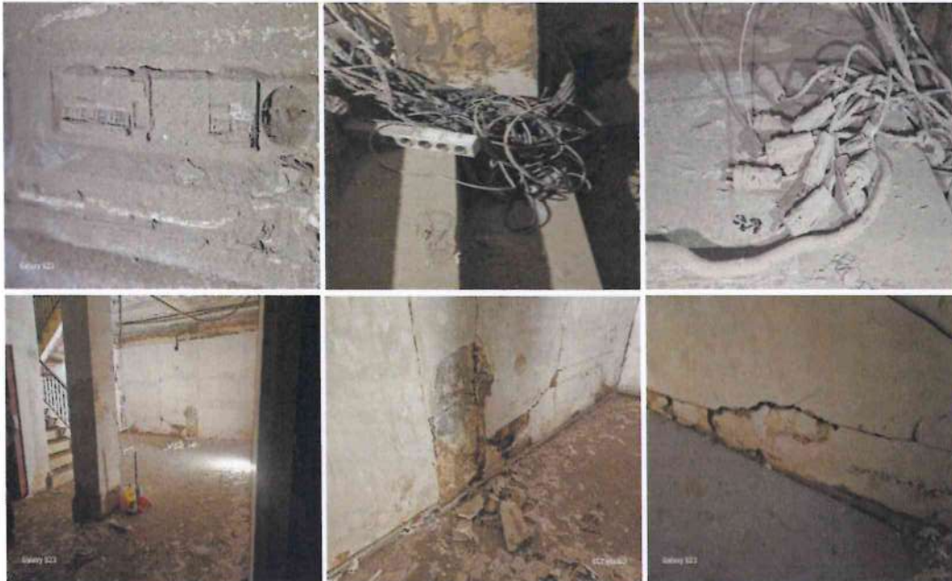
Imagen 7 - Instalaciones eléctricas y muros dañados por la DANA
