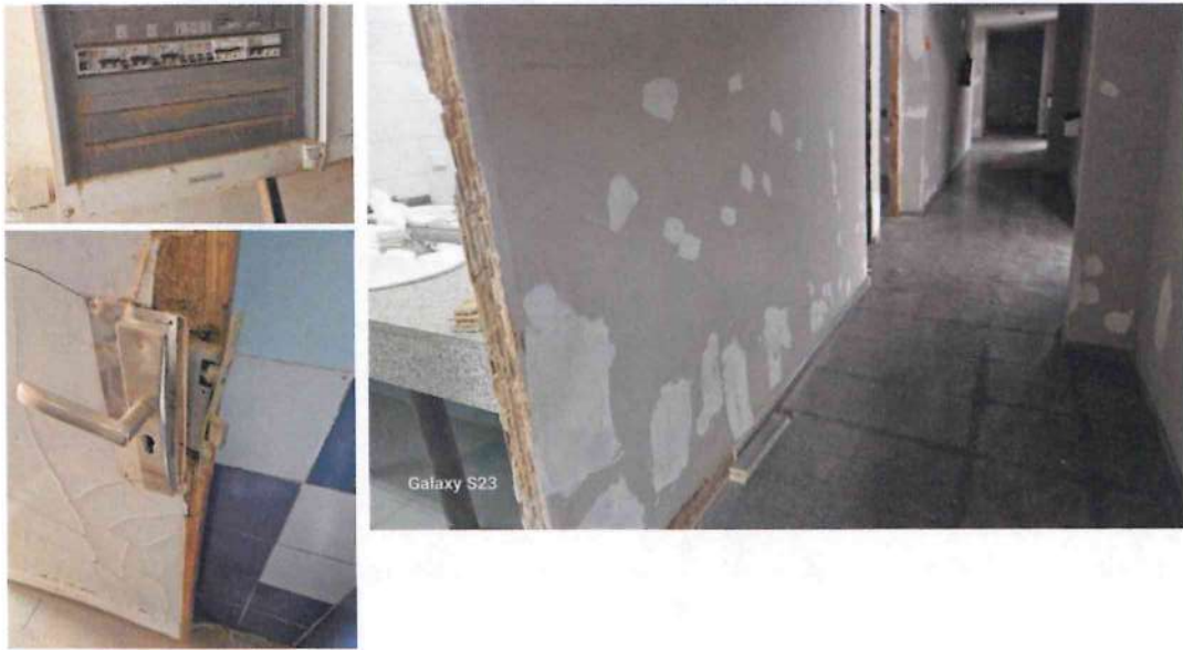
Imagen 3 - Cuadros eléctricos, carpintería y premarcos afectados por el agua (2,5 m de altura)
