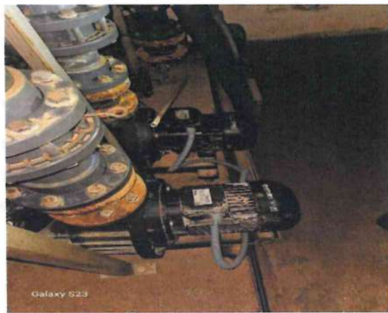
Imagen 2 - Bombas y depuradoras averiadas
