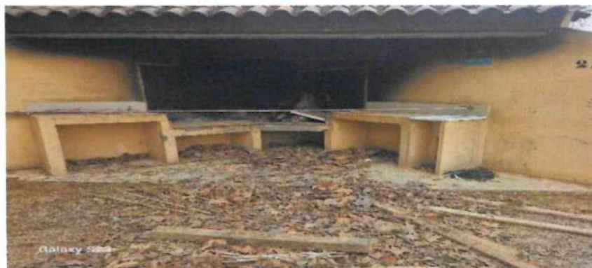
Imagen 4 - Paelleros destruidos y en estado inservible
