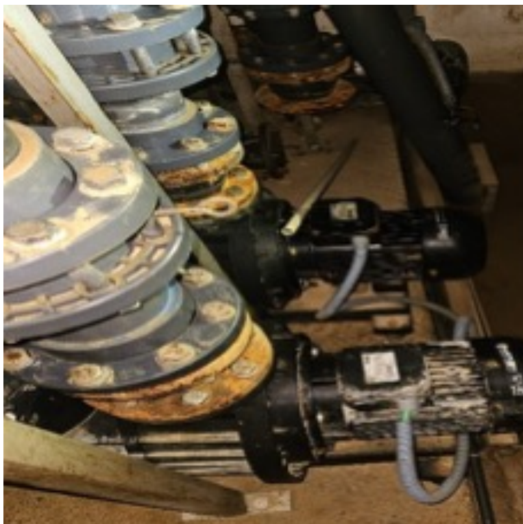
BOMBAS Y DEPURADORAS AVERIADAS
