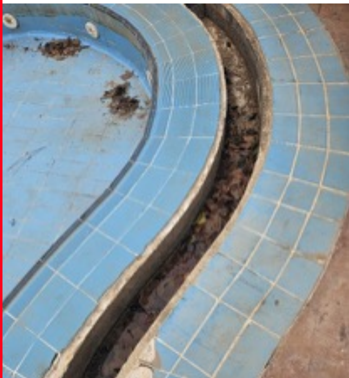
PISCINA SIN REJILLAS Y PAVIMENTO CERÁMICO ROTO
